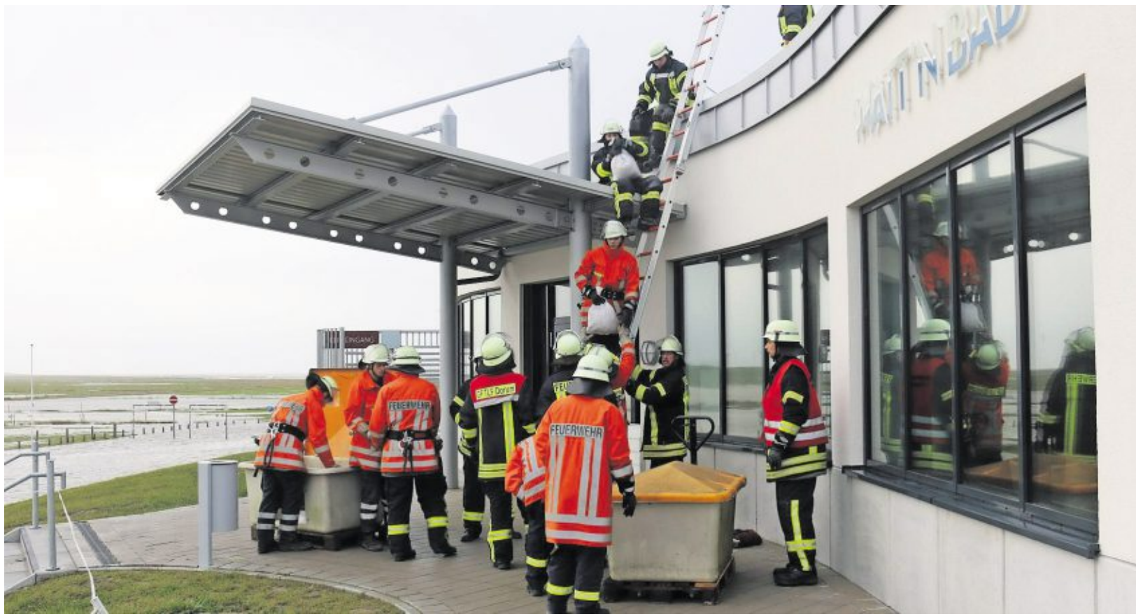
Arbeit unter erschwerten Bedingungen: 200 Sandsäcke hieven die Feuerwehrkameraden aus Dorum und Padingbüttel am Sonnabend aufs Dach des Watt'n Bads. Mit diesen sollte die Konstruktion stabilisiert und das Dach gesichert werden. Foto: Rottmeier
